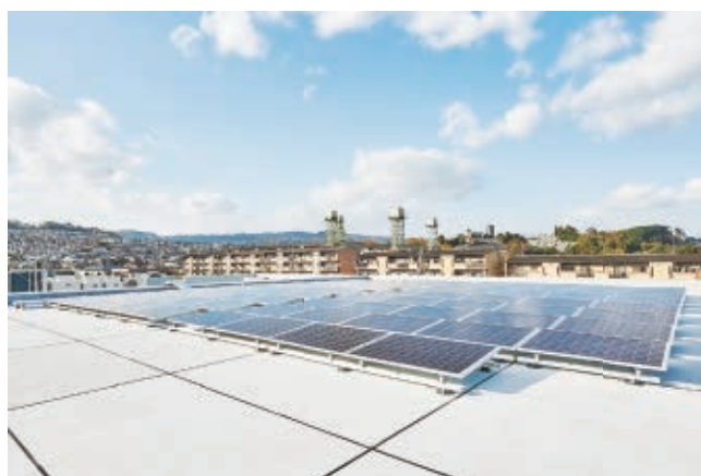
太陽光発電システム(屋上)
