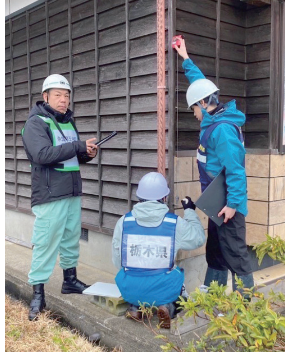
▲全国から集まった自治体職員と協力して、家屋の被害認定調査を行う様子（石川県穴水町）
