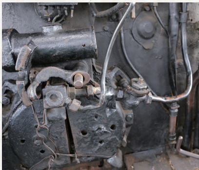
焚口戸に取り付けられた重油バーナー
