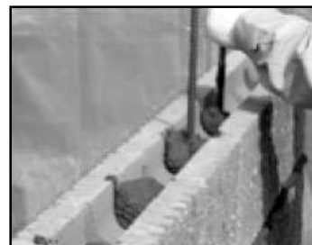
⑥ 縦筋の部分、縦目地の空胴部分にモルタルを詰める
