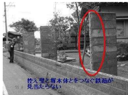
写真9 地震で塀本体が倒壊した例
